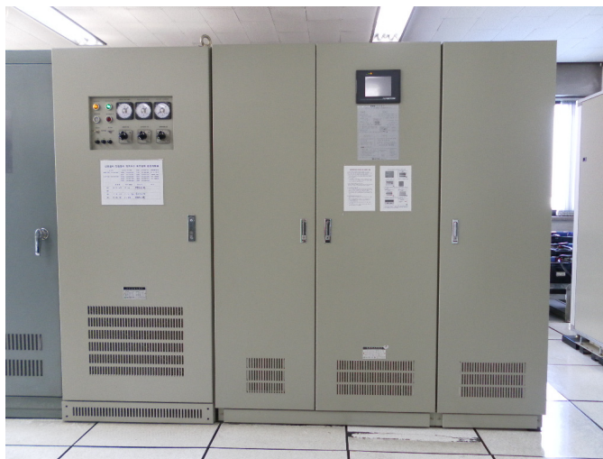
[그림 2-5] UPS 및 AVR 설치
