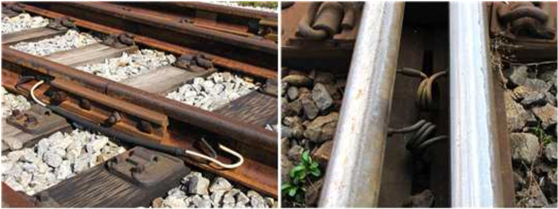
녹이 슨 상태의 레일 상태
